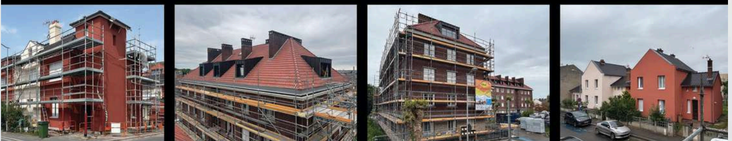
Réhabilitation et aménagement de 74 logements collectifs et individuels, rues Vion & Jean Boën, Amiens (80) / Maître d'Ouvrage : ICF HABITAT NORD-EST CHANTIER EN COURS
